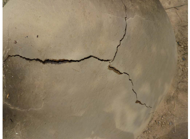
Abb. 14 In der Lehmwand bildeten sich Risse.
